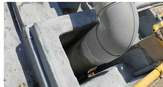
FOTO 8 - PATINILLO PARA EL PASO DE LAS BAJANTES DE CUBIERTA, ESTÁ DESCUBIERTO Y EL AGUA DE LLUVIA SE INTRODUCE A TRAVÉS DE ÉL.
