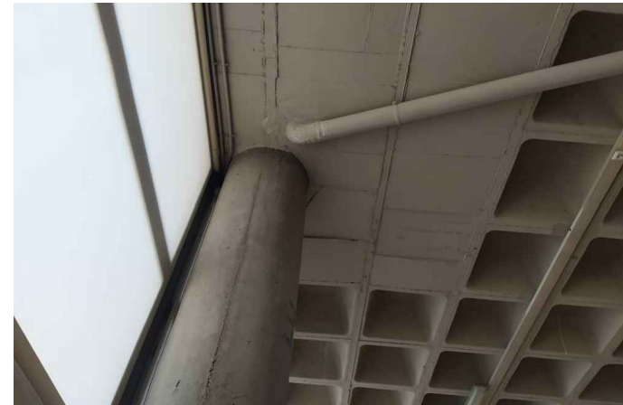
FOTO 10 - RESTOS DE CAL DERIVADOS DE LAS FILTRACIONES POR LAS JUNTAS DE LA RED DE EVACUACIÓN.
