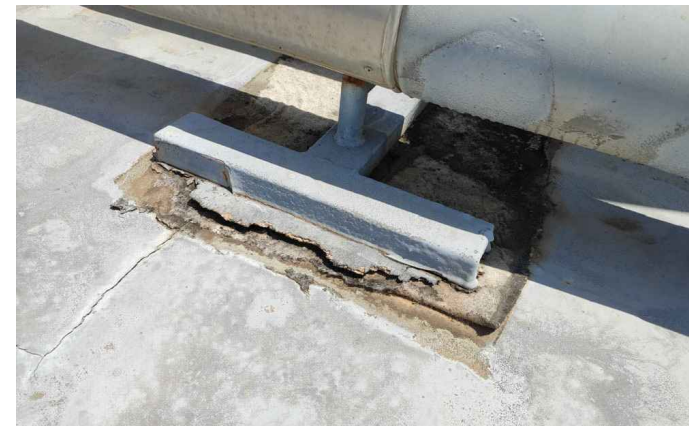
FOTO 5 - ELEMENTOS DE APOYO DE CONDUCTOS DE INSTALACIONES SIN APOYOS ELASTOMÉRICOS.
