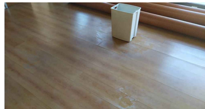
FOTO 12 - RESTOS DE CAL DERIVADOS DE LAS FILTRACIONES.
