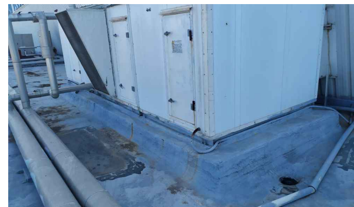
FOTO 7 - CONDUCTOS Y ELEMENTOS QUE DIFICULTAN LA CORRECTA EVACUACIÓN DE AGUA.
