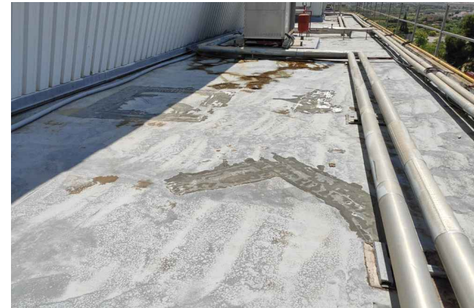
FOTO 6 - EXISTENCIA DE PARCHES Y REPARACIONES EFECTUADAS EN LA CUBIERTA CON ANTERIORIDAD.
