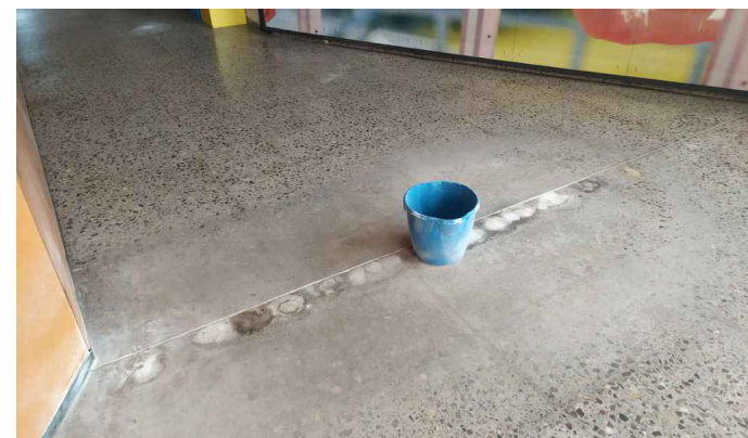
FOTO 11 - RESTOS DE CAL DERIVADOS DE LAS FILTRACIONES.
